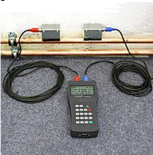
El caudalímetro por ultrasonido PCE-TDS 100HS efectuando una medición en una tubería
