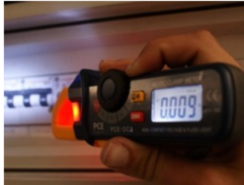
Detectando el voltaje de un cuadro eléctrico en condiciones de baja luminosidad.
