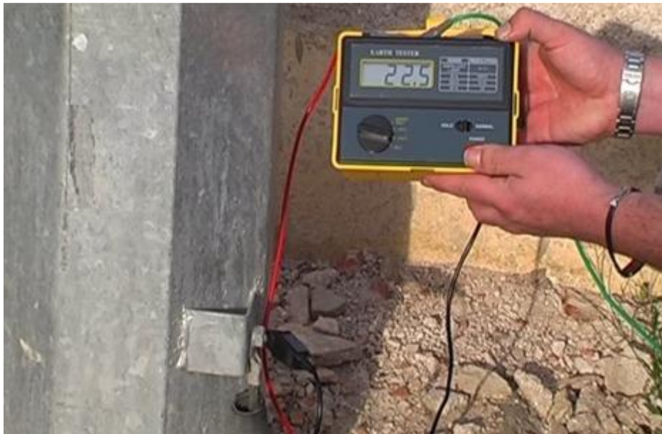
El controlador de puesta a tierra PCE-ET 3000 midiendo la resistencia contra tierra de una instalación eléctrica.
