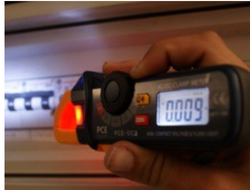
Detectando el voltaje de un cuadro eléctrico en condiciones de baja luminosidad.
